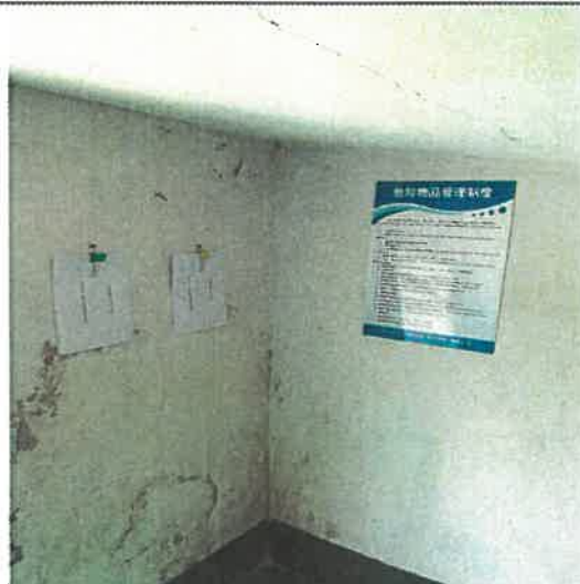
图 3-4-2 危险废物仓库
