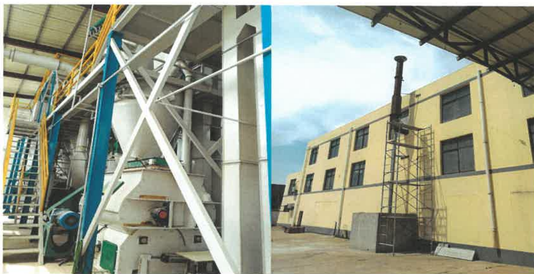
图 3-2 旋风+脉冲除尘装置排气筒图
