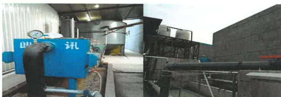
图 3-2 污水处理循环设备图
