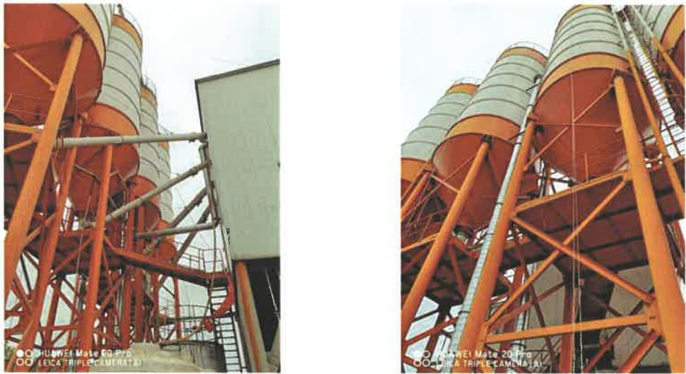
图 3-4 废气治理设备图
