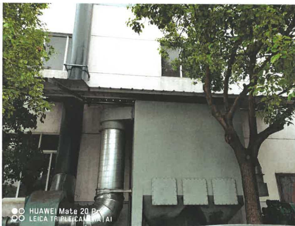
图 3-4 废气治理设备图
