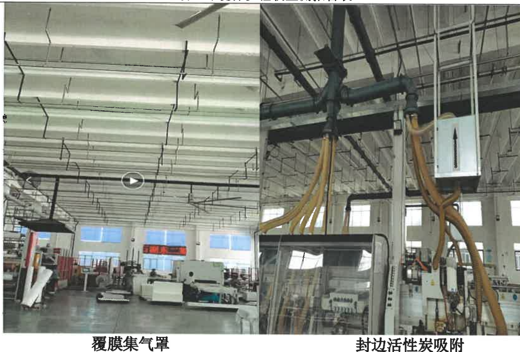
图 3-2 废气治理设备图
