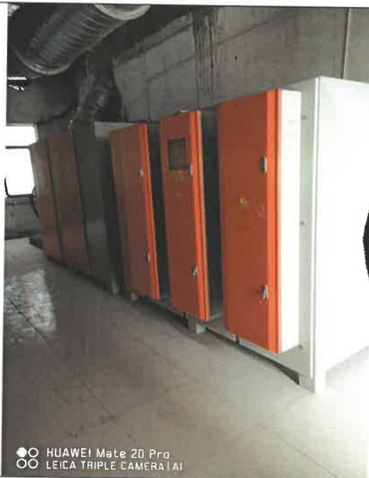
光氧催化处理设施 图 3-4 废气治理设备图
