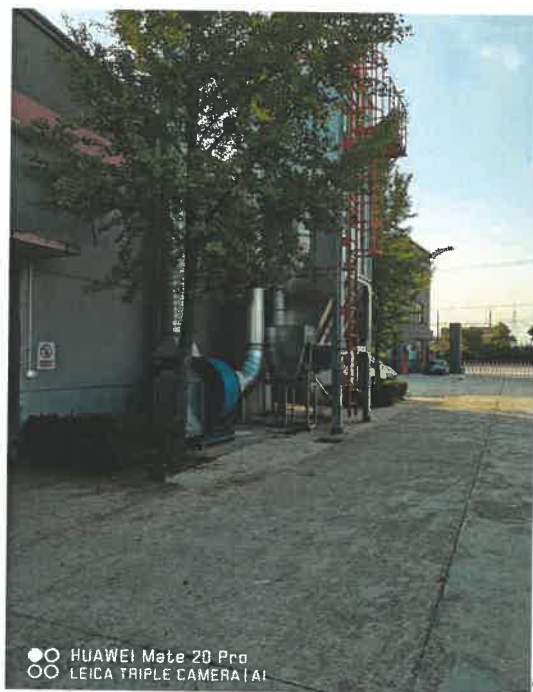
中央集尘处理设施
