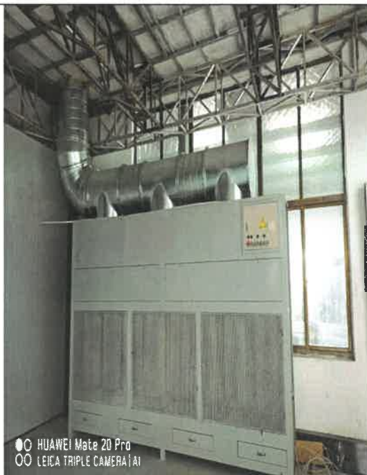
干式打磨台脉冲除尘 图 3-4 废气治理设备图
