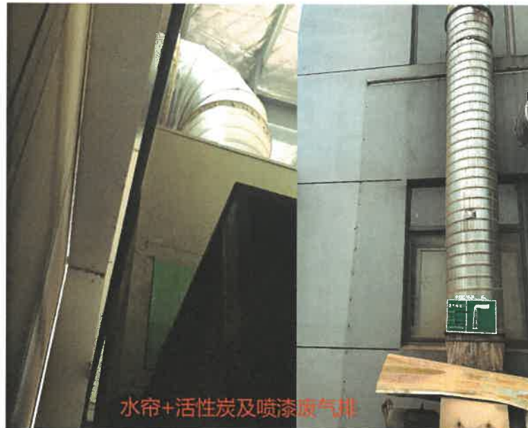
图 3-2 建设项目废气治理措施现状图
