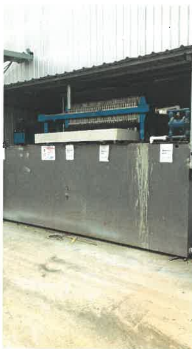
图 3-1 建设项目废水絮凝沉淀措施现状图
