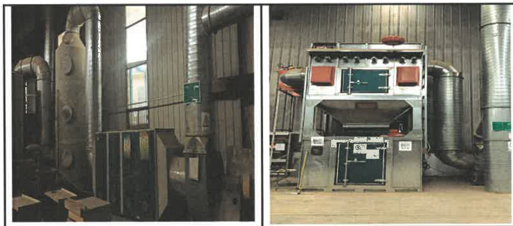
图 3-2 废气治理措施现状图
