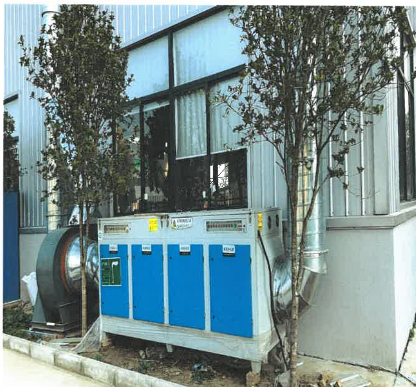
图 3-3 废气治理设备图
