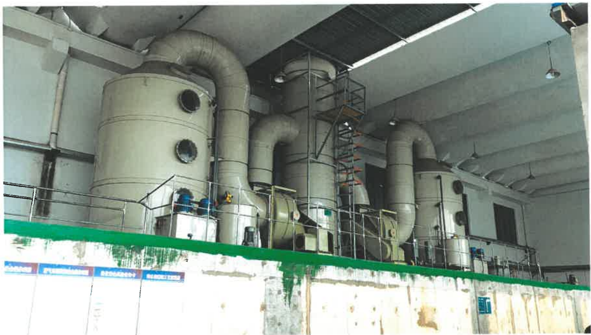
图 3-3 废气治理设备图
