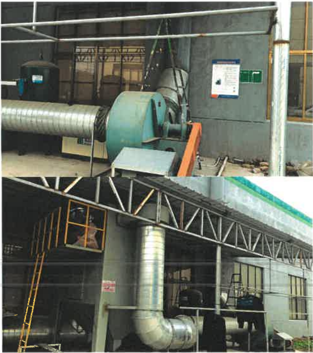
图 3-2 建设项目废气治理措施现状图
