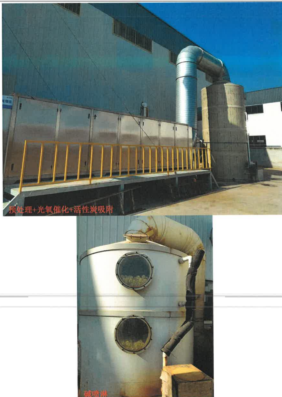
图 4-4 废气治理排放措施现状图
