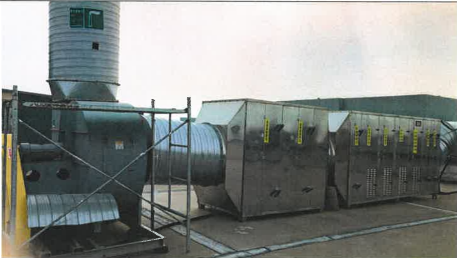
图 3-3 废气治理设备图
