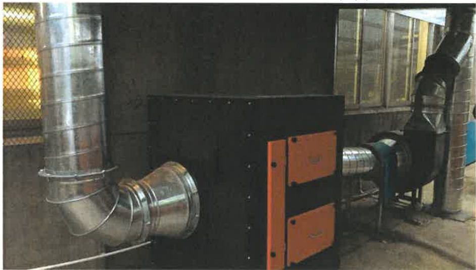
图 3-2 废气治理设备图
