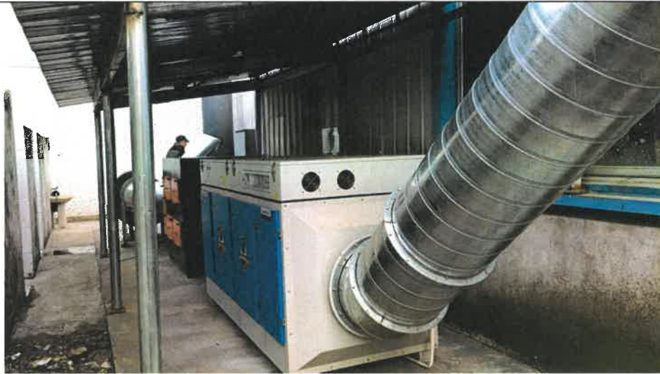
图 3-2 废气治理设备图
