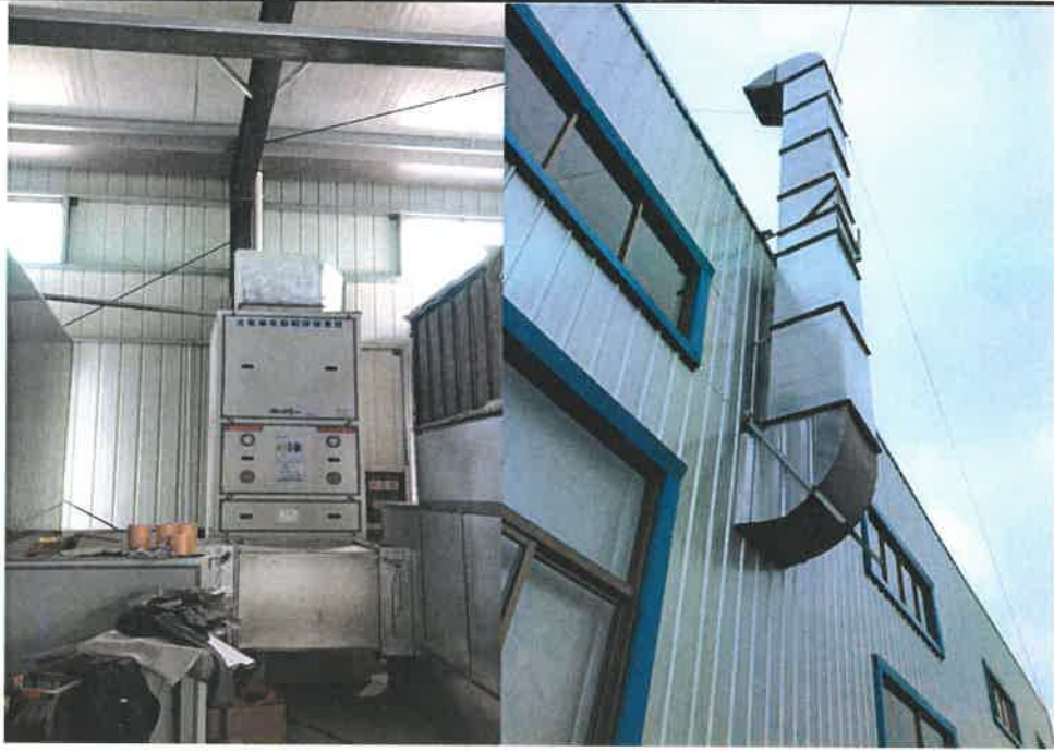
图 3-2 喷烤漆废气治理措施现状图
