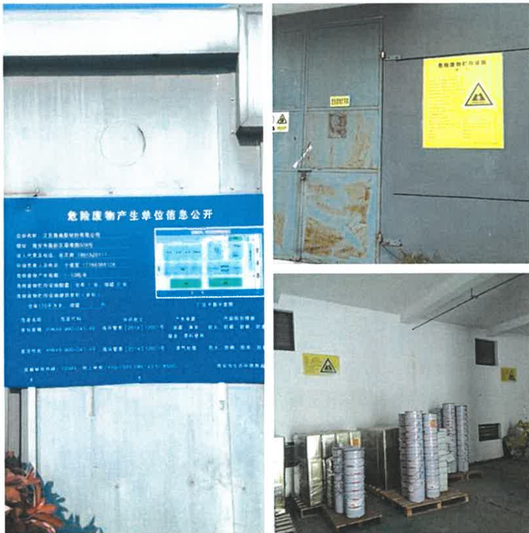
图 3-4 危险废物暂存场所
