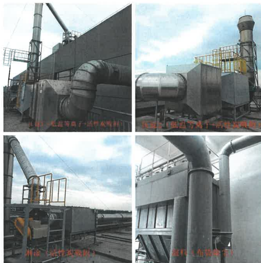
图 3-2 废气治理措施现状图
