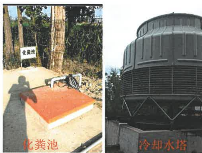
图 3-1 建设项目废水治理设施图
