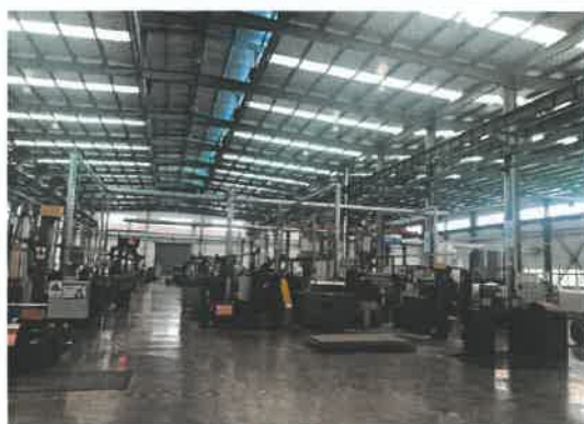
生产车间内部集气罩废气管道
