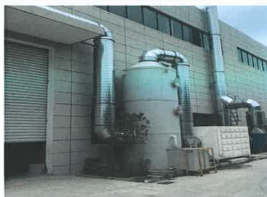
1#排气筒（碱喷淋+活性炭吸附）
