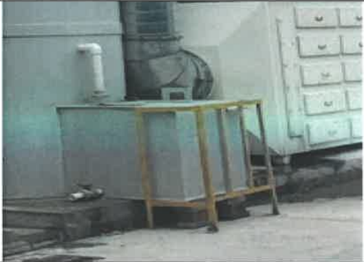
碱喷淋循环水箱
