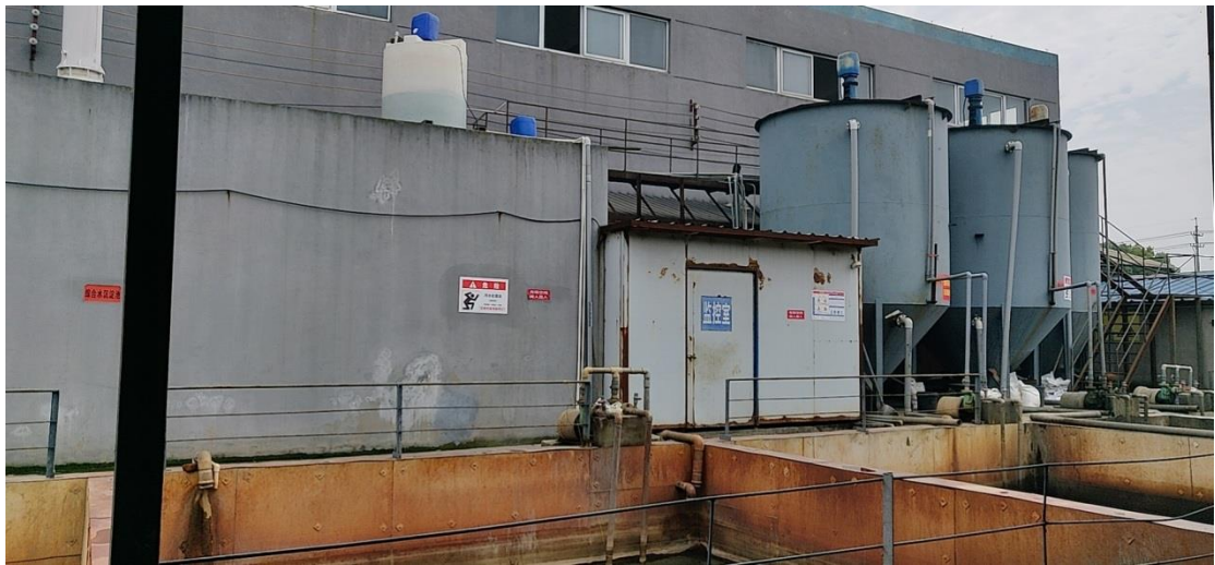
图 4.2-1 污水处理站情况
