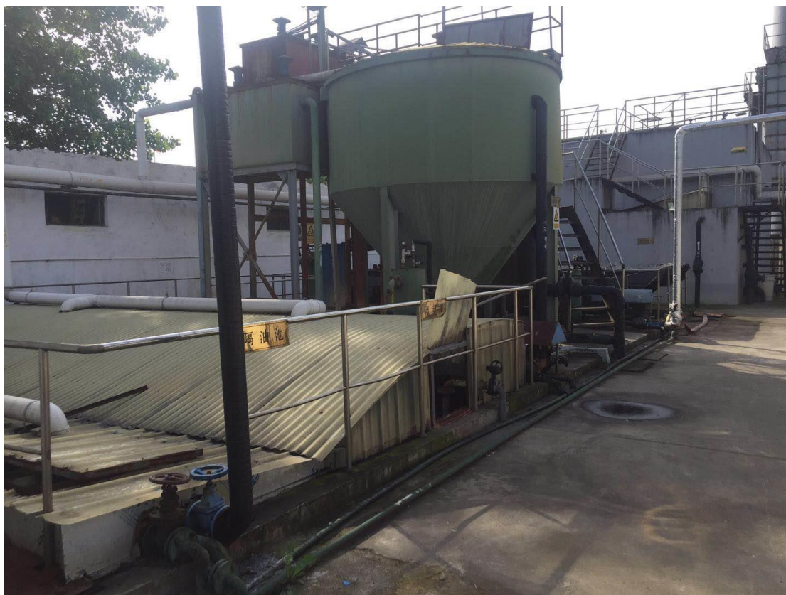
图 4.2-1 污水处理站情况
