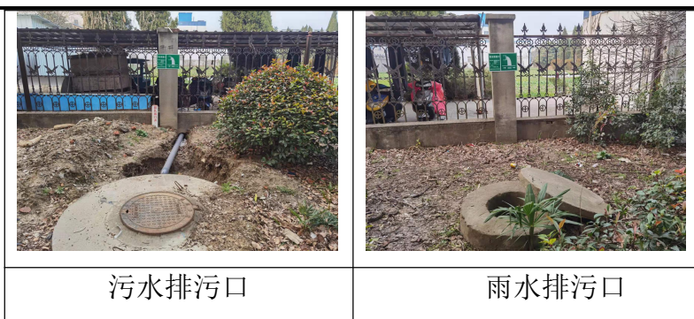
图 3-5 污水、雨水排污口
