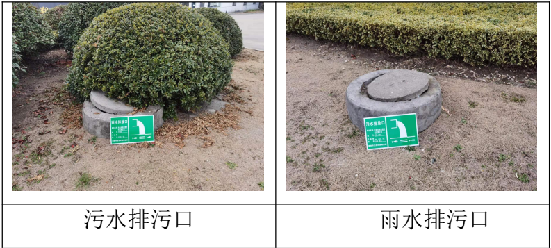
图 3-2 污水、雨水排污口
