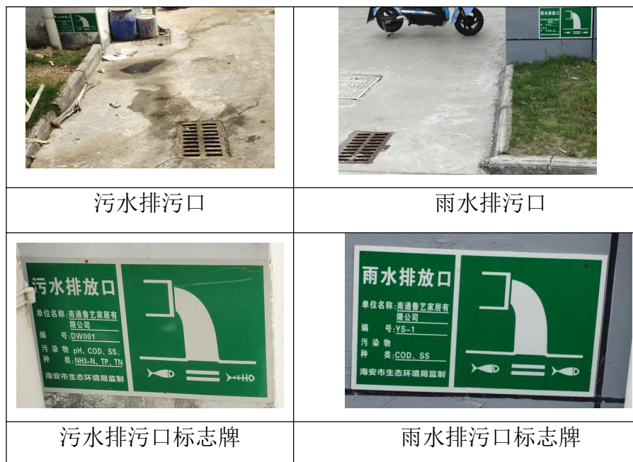
图 3-6 污水、雨水排污口
