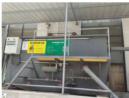
图 3-2 废水处理设备
