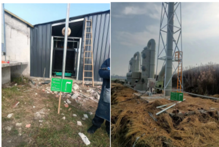
图 4.1-7 废气标识牌现状图
