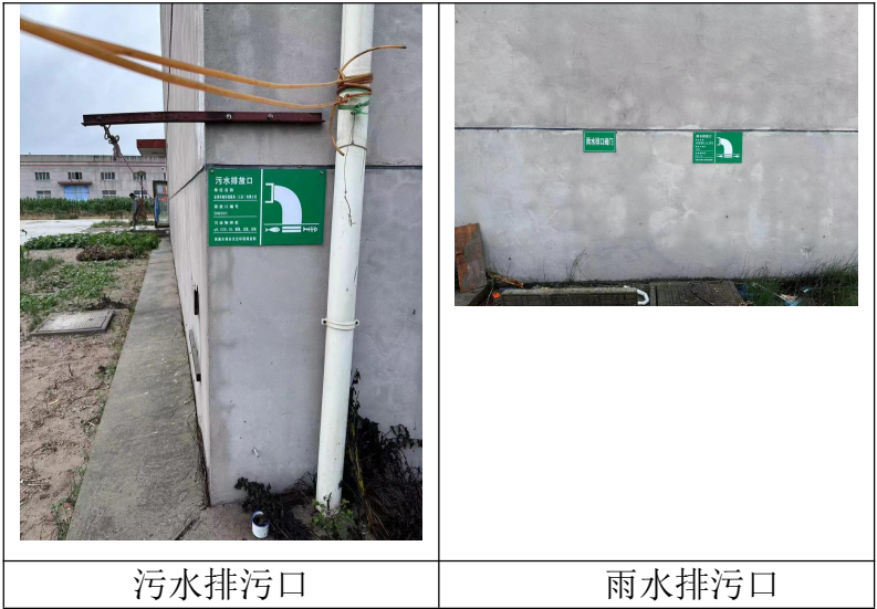
图 3-5 污水、雨水排污口
