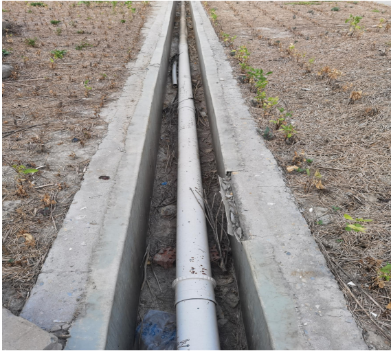
车间与水处理设施连接管道
