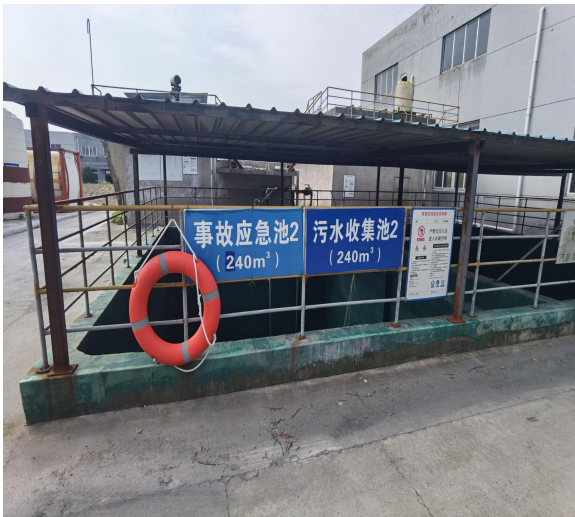
废水收集池事故池
