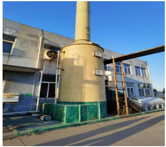
腐蚀车间废气吸收塔
