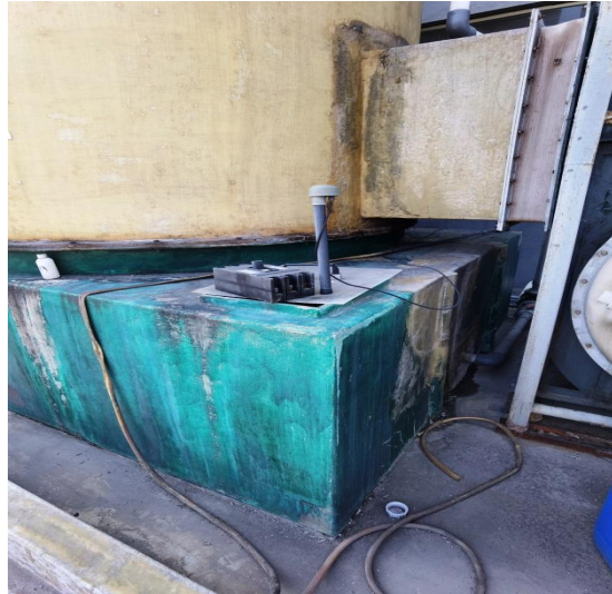
喷淋塔 PH 自动控制装置
